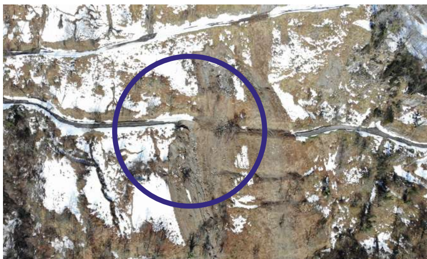
Effondrement sur la piste d'Arriutort
