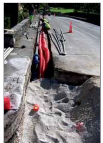
Entrée sud : les réseaux
