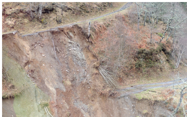
Zone de décrochement sur la piste des Cinq Monts qui est descendue d'1,5m lors des intempéries de décembre 2019.
