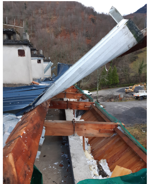
Toiture d'un bâtiment communal arrachée par le vent en décembre 2019.
